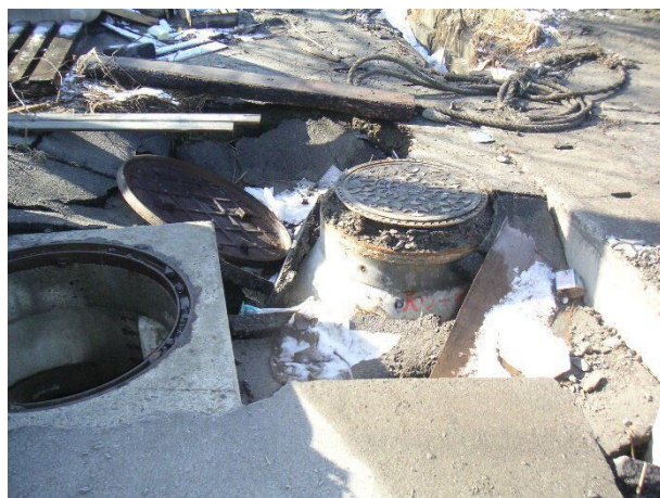
マンホールの被害（久慈市）
