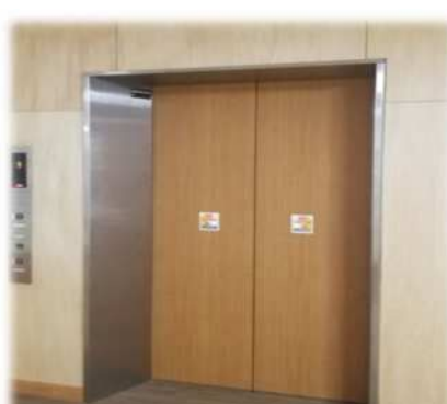
エレベーター
