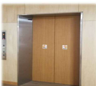
エレベーター 3
