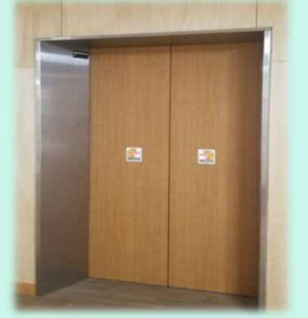
【エレベーター】
