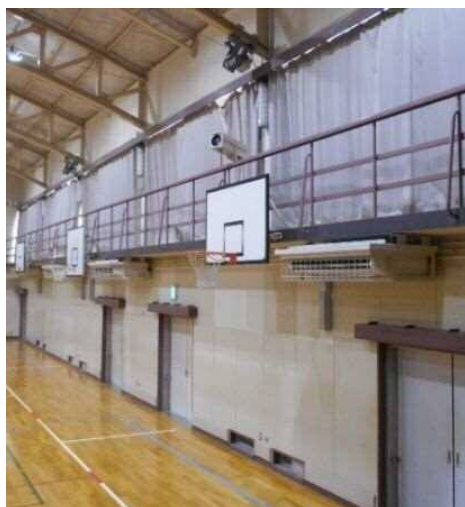
【体育館に設置されている空調設備】
