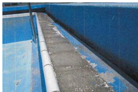
【図 2-8】老朽化したプール水槽
