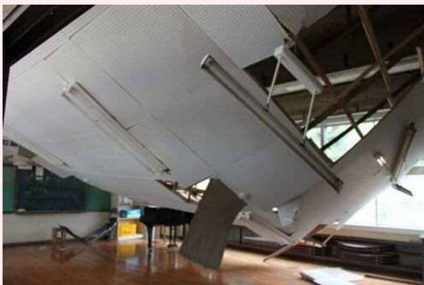
雨漏りにより天井の木製吊り部材が腐食して落下 (築 50 年)
