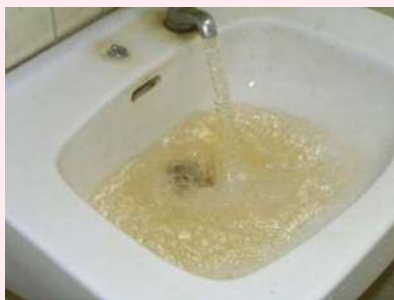
職員トイレの手洗から赤水発生 古い配管のサビが原因です。
