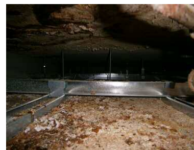
【図 2-9】雨漏りで浸食された天井裏
