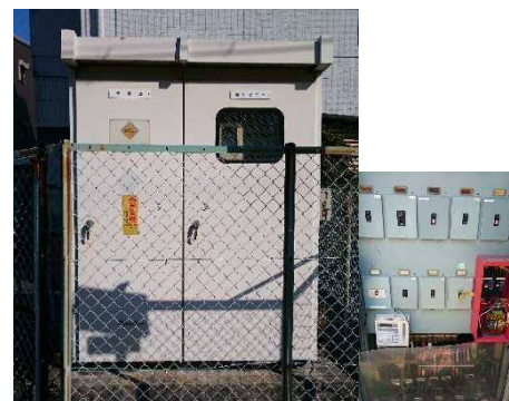
【図 2-11】古くなった受変電設備(内部)
