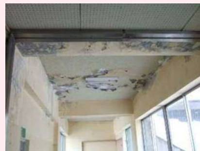
雨漏りにより天井が劣化 (築 38 年)
