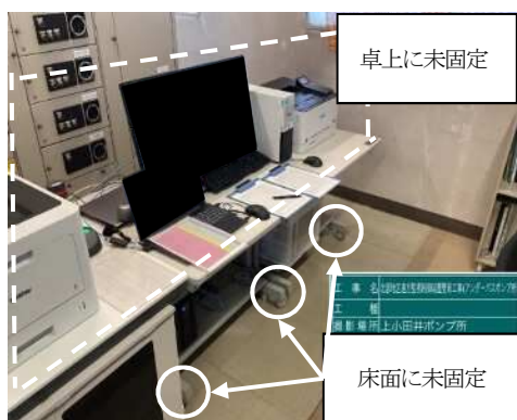
上小田井ポンプ所監視制御装置の状況
