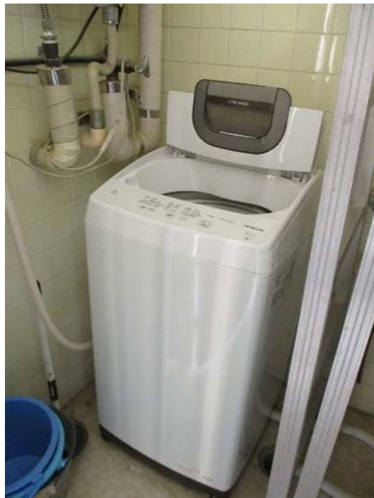
1 階 洗濯機（令和 6 年）
