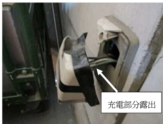
コンセント破損状況
