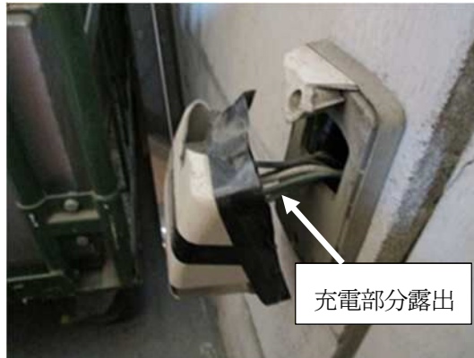
コンセント破損状況
