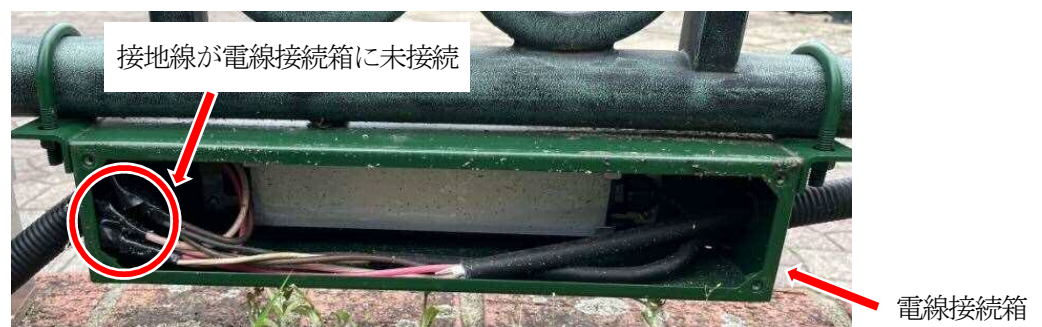
電線接続箱 (中間部) の状況
