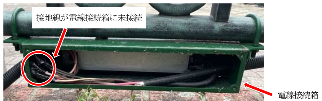
電線接続箱 (中間部) の状況
