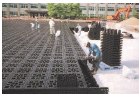
校庭に設置した貯留施設
