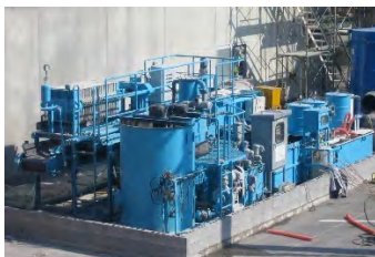
凝集沈殿装置
