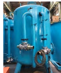
活性炭吸着塔
