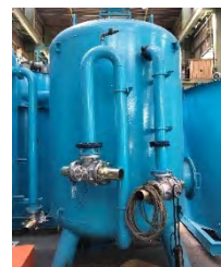
活性炭吸着塔
