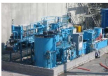
凝集沈殿装置
