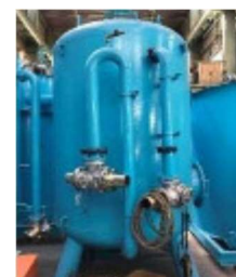
活性炭吸着塔
