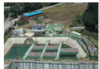
濁水処理設備と竹ソダ式沈砂池
