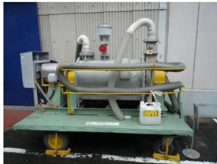
ガス吸収装置
