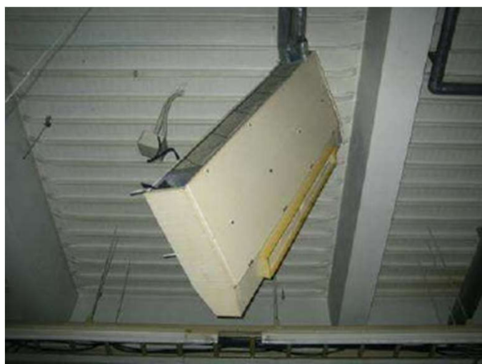
吊りボルトの破断例
