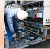
フロンガス回収 (環境省HPより)
