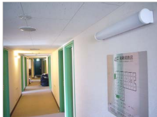
▲ 客室フロアの廊下でも一部を消灯
