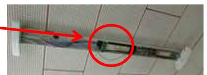
蛍光灯の安定器
