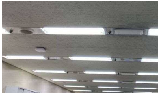
ご利用例：LED 照明への入替
