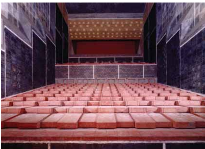
写真 1-2-2 ストーカ炉内部（図 1-2-8 の □ から見たところ）
