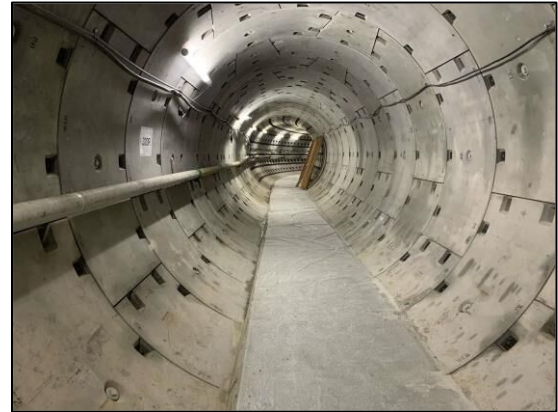
写真 3-2-3-1 (4) 名城変電所（電気洞道）
