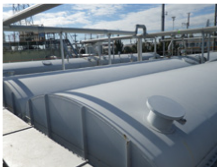
嫌気性排水処理設備
