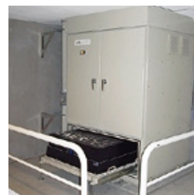
蓄電システム(蓄電池)
