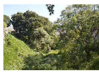
写真 4-59 土塁・堀に繁茂した樹木・草本類 (御園橋東)
