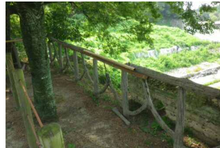
写真 4-70 擬木柵の欠損部 （二之丸北南蛮練堀付近）
