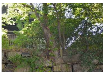
写真 4-57 石垣に影響を与える樹木 (巾下門枡形石垣)
