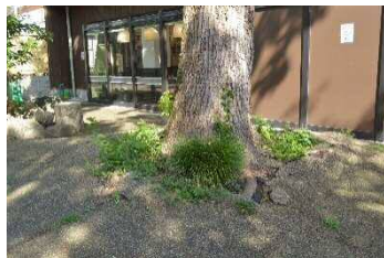
写真 4-40 園路舗装の不陸を生じさせている クスノキ(売店・飲食店南)
