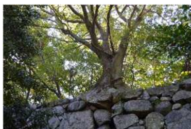
写真 4-29 石垣の保存に影響を与える樹木 (西側多聞櫓台石垣)
