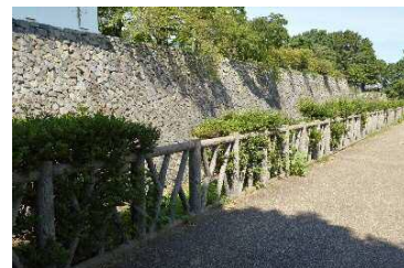
写真 4-14 補植されていない灌木 （東南隅櫓東）
