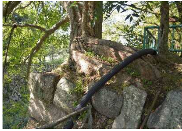
写真 4-43 石垣をき損している樹木（アキニレ） （西側塙の首）
