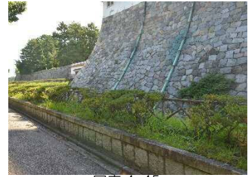
写真 4-45 補植がされていない灌木 （内堀外周北側）
