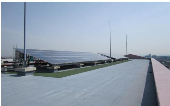
写真 2-13-15 太陽光発電設備の装置
