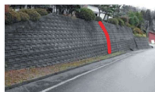
擁壁下端のハラミ出し
