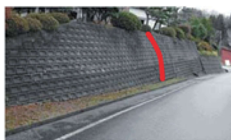
擁壁下端のハラミ出し
