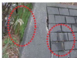
水がしみだしている擁壁
