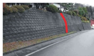
擁壁下端のハラミ出し
