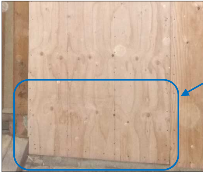
No. 10 壁① 1階 X7-Y10~11 構造用合板下部
