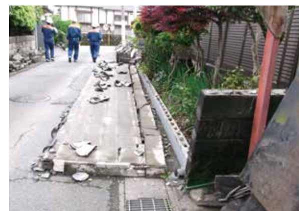
倒壊したブロック塀
