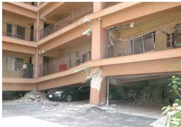
1階ピロティの被害
