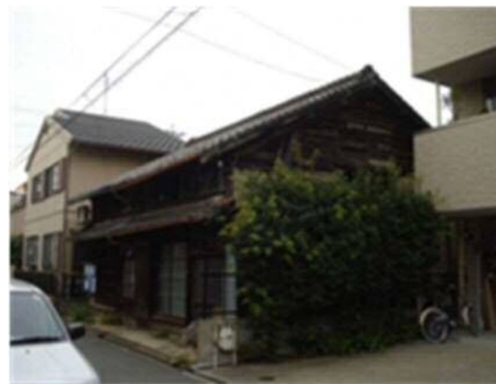
保安上危険な特定空家等の除却事例
