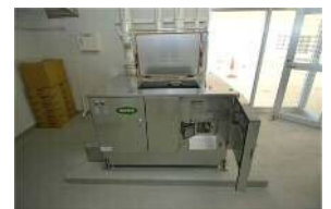
ゴミの減容化・減量化、 堆肥化するための設備 （生ごみ処理機）の設置
