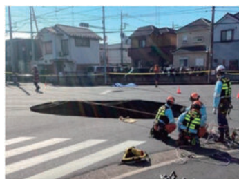
写真：道路陥没の事例
