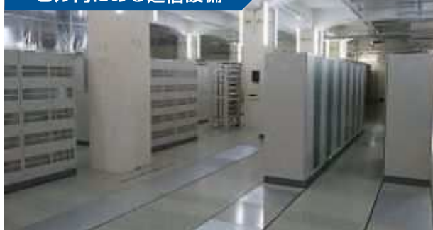
ビル内にある通信設備
