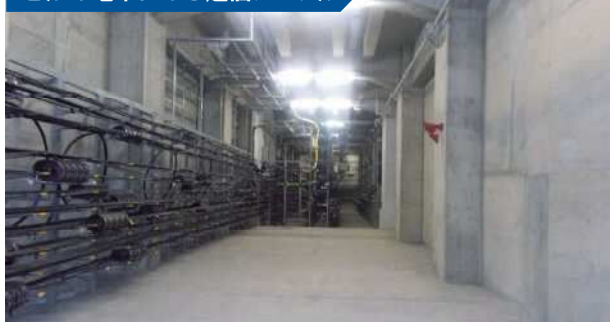
ビルの地下にある通信ケーブル
