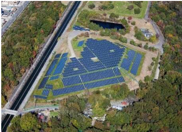
○太陽光発電設備 全景
