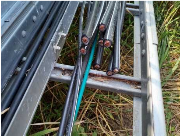
○電線盗難箇所
