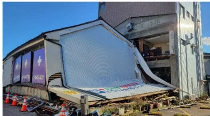
1階部分が倒壊し潰れた店舗（七尾市）
