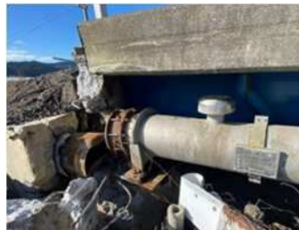
水道管の被害 （珠洲市）
