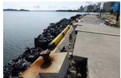
護岸倒壊（和倉港）
