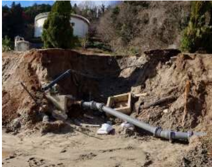
【水道】 浄水場内の土砂崩壊
