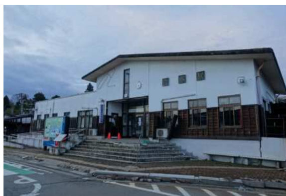
亀裂・段差被害 （のと鉄道穴水駅）
