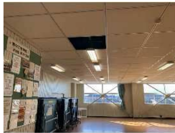
建物（天井落下）被害 （野々市市）
