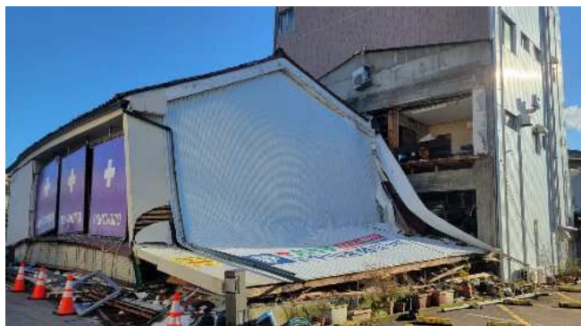
1 階部分が倒壊し潰れた店舗
