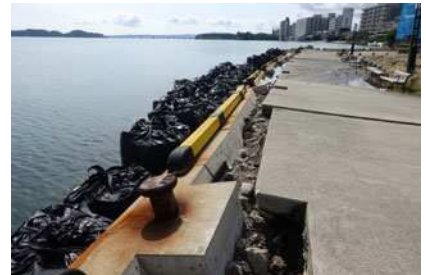
護岸倒壊（和倉港）
