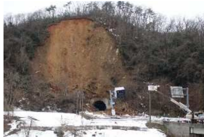
土砂崩れ（能登町）
