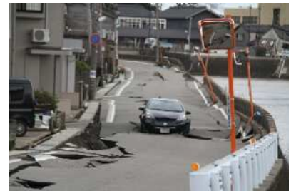
道路被害 （輪島市）
