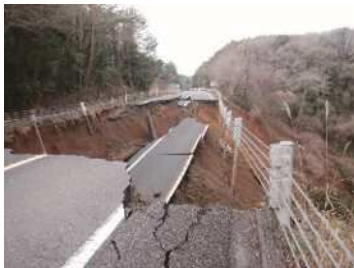
道路崩壊（のと里山海道） （七尾市）
