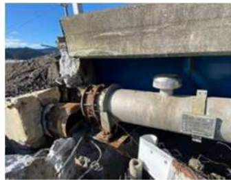
水道管の被害 (珠洲市)
