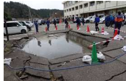
駐車場陥没被害 （能登町）
