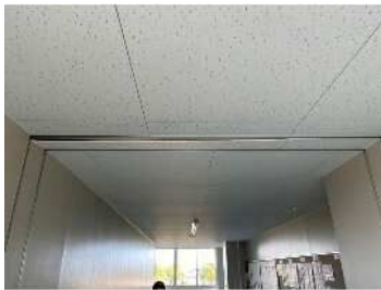
建物（建物ズレ）被害 （野々市市）
