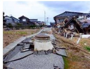
液状化によるマンホールの浮上 (珠洲市)
