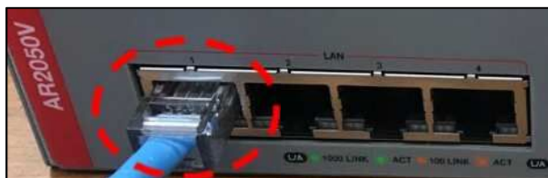
無線ルータ (LAN ポート)
