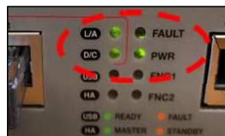
無線ルータが点灯
