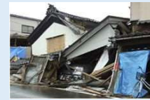
住宅被害の一例
