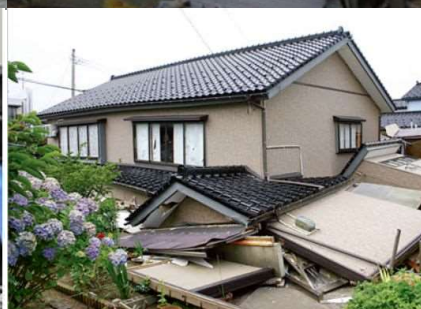
全壊 損害割合 50%以上
