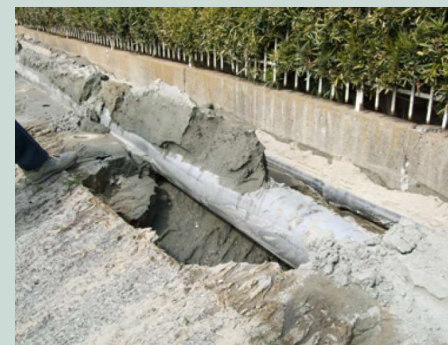
埋設配管の浮き上がり 国土交通省ホームページより
