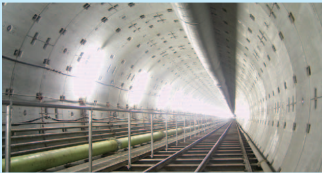
写真⑬ 東海豪雨後、整備された雨水貯留管
