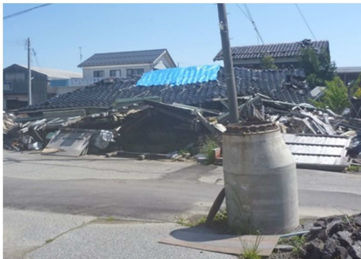
令和6年1月 能登半島大地震 (液状化により浮上したマンホール)
