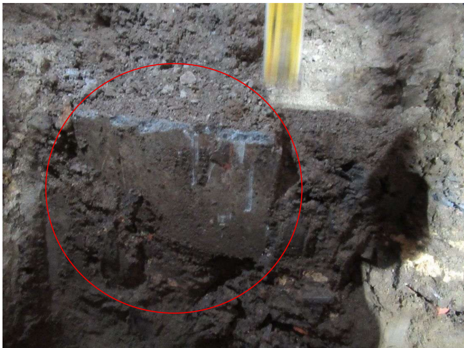
図 2.2-8 南面コンクリート塊
