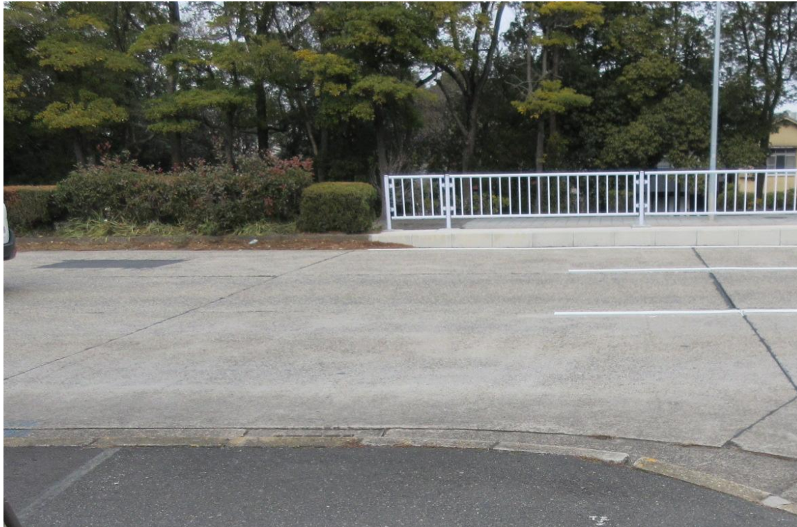
古いコンクリート舗装
