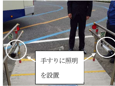
照明の設置状況
