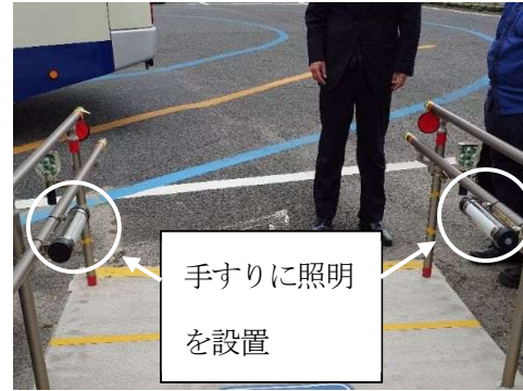
照明の設置状況
