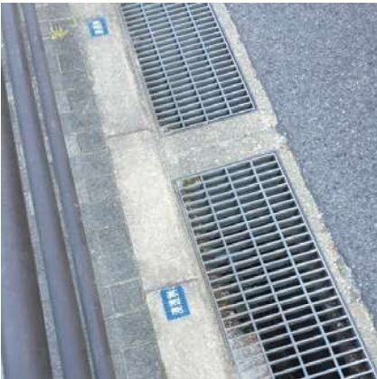
雨水浸透ます
